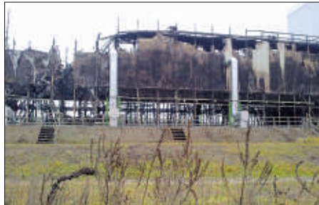
Optisch erinnert es an die havarierten Reaktorblöcke in Fukushima: Das abgebrannte Kühlhaus des Holzkraftwerkes Eberswalde.
